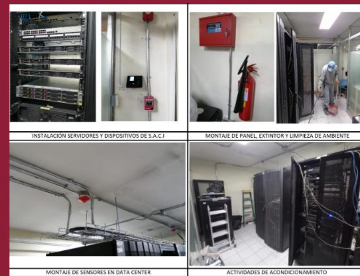
Data Center - Servidor
