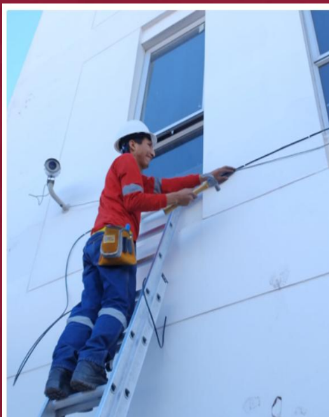
Cámaras de Vigilancia
