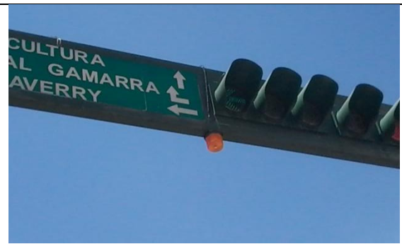
Circulina instalada para emergencias
