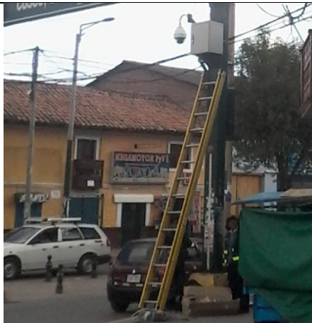
Instalación de cámara PTZ – Ovalo de Tacna
