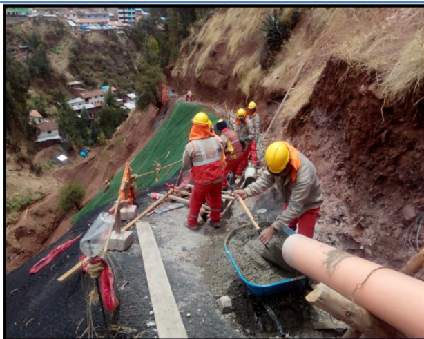
SISTEMA DE PROTECCION 07 BATEAS
